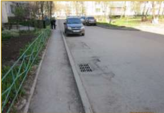
Фото объекта «До»
