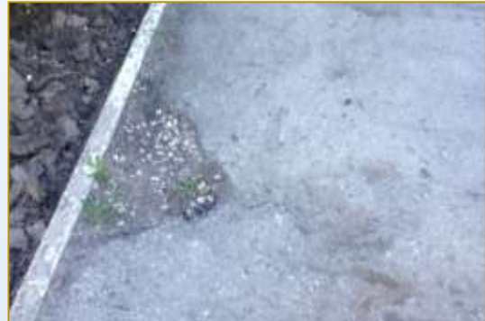
Фото объекта «До»
