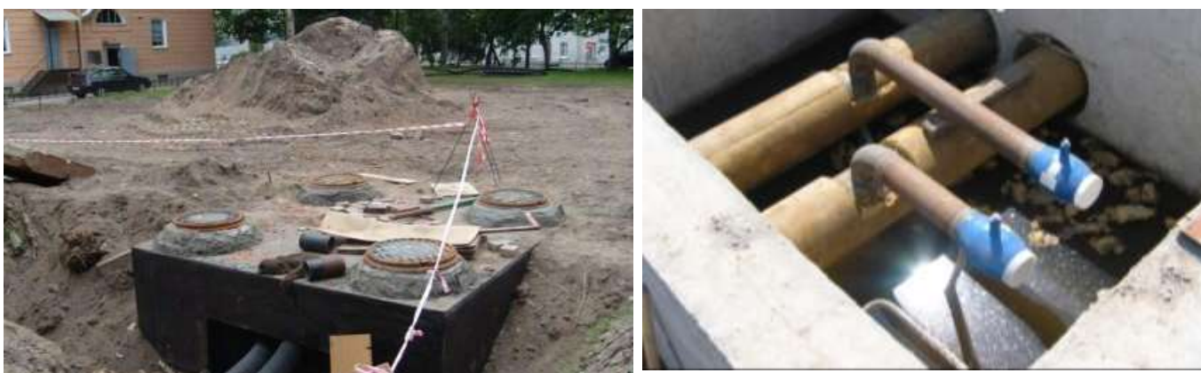
Рисунок 28 – Тепловые камеры в подземном исполнении
